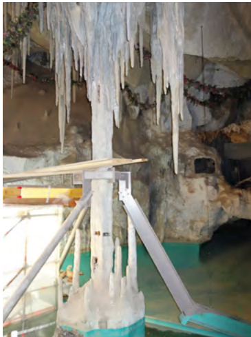
Sicherung der Stalaktiten, die bis zu 7,50 Meter lang und 500 Kilogramm schwer sind
