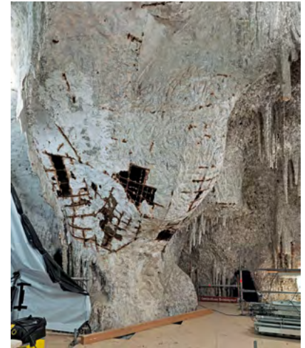
Korrosionsschäden an der Drahtputzschale der Venusgrotte
